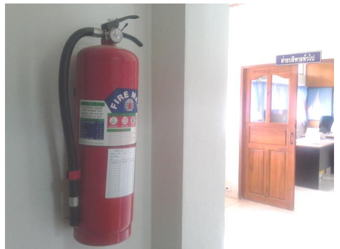
จัดสถานที่เก็บถังดับเพลิง และตรวจสอบสภาพ
